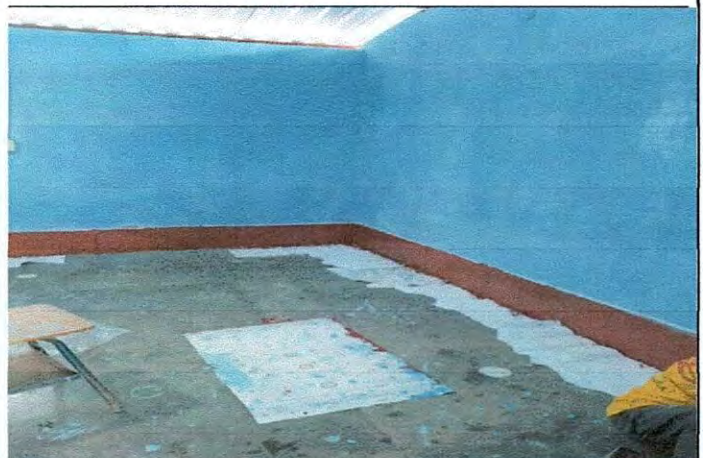
Foto 4: Pintado interior de aula.
